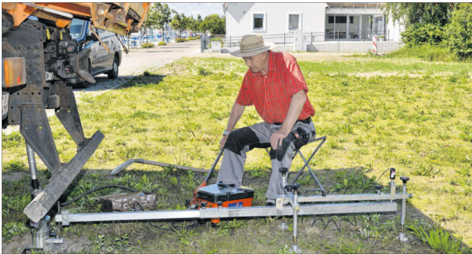
Peter Nemzow vom gleichnamigen Erdlabor aus Kemnitz prüft in Wieck nahe der Nordmole die Festigkeit des Bodens.
